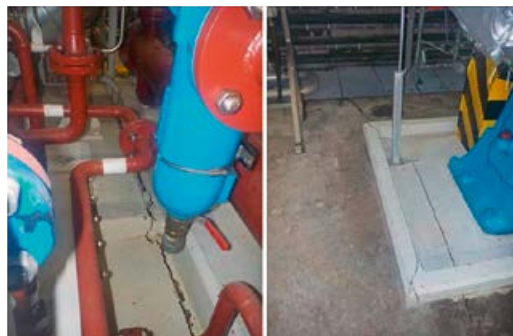
Abbildung 1: Beispiele für Schäden im W-Gebäude. Quelle: IRS-Bericht 8730
