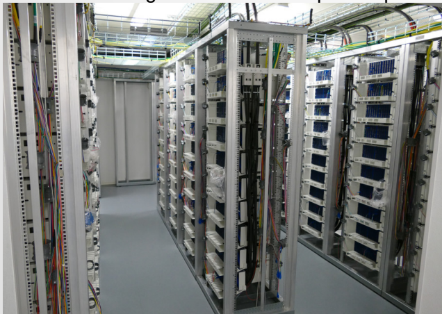
Salle de brassage d'un NRO Free point à point :
