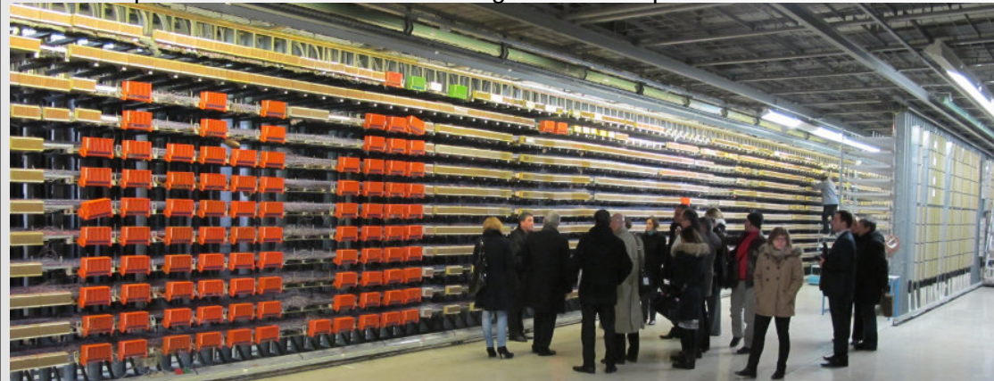
Salle du répartiteur cuivre d'un NRA Orange de 63 000 paires de cuivre :
