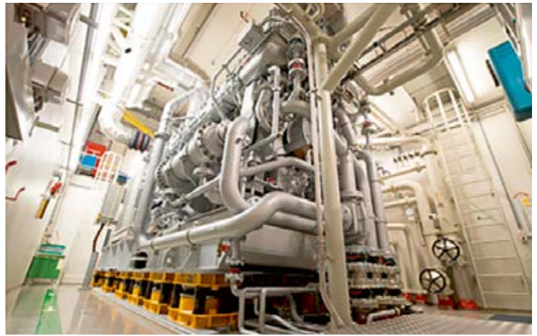
Abbildung 1: Seismische Ertüchtigung der Lager eines Notstromdieselaggregates in einem Schweizer Kernkraftwerk. Das ganze Aggregat ist auf Federn gelagert, die Erdbebanregungen abdämpfen. Quelle: Kernkraftwerk Gösgen
