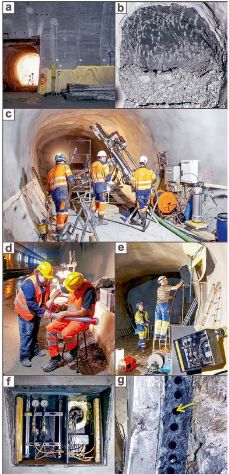
Abbildung 42: (a) Querverbindung 5a, ca. 6,3–11,3 m nördlich des Messquerschnitts (Abb. 1, Abb. 2), (b) Ungesicherte Ortsbrust der Querverbindung 5a, (c) Bohrarbeiten für die Bohrung CP-2 (Abb. 4) und Einrichtungen für hydraulische Tests, (d) Bohrlochversiegelung kurz nach den Bohrarbeiten, (e) Installation des Doppelpackersystems für Porenwasserdruck-Messungen in der Bohrung CP-4 (Abb. 4), Installation des Systems für Datenerfassung und Kontrolle von hydraulischen Messungen, (f) Installierte Messeinrichtungen in der Ort beton-Innenschale, und (g) Kurze Bohrung (<1 m, gelber Pfeil) für die Entnahme von Proben des Ringspaltmörtels. Quelle: Forschungsbericht ETH Zürich 2017 (Anhang A).
