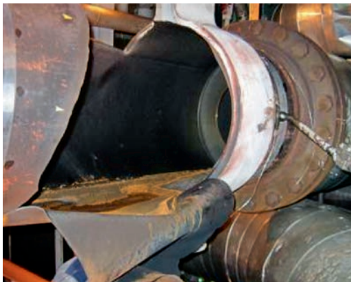
Abbildung 9: Bruch der Speisewasserleitung in der japanischen Anlage Mihama-3 im Jahr 2004. Quelle: OECD-NEA «Topical Report on FAC».
