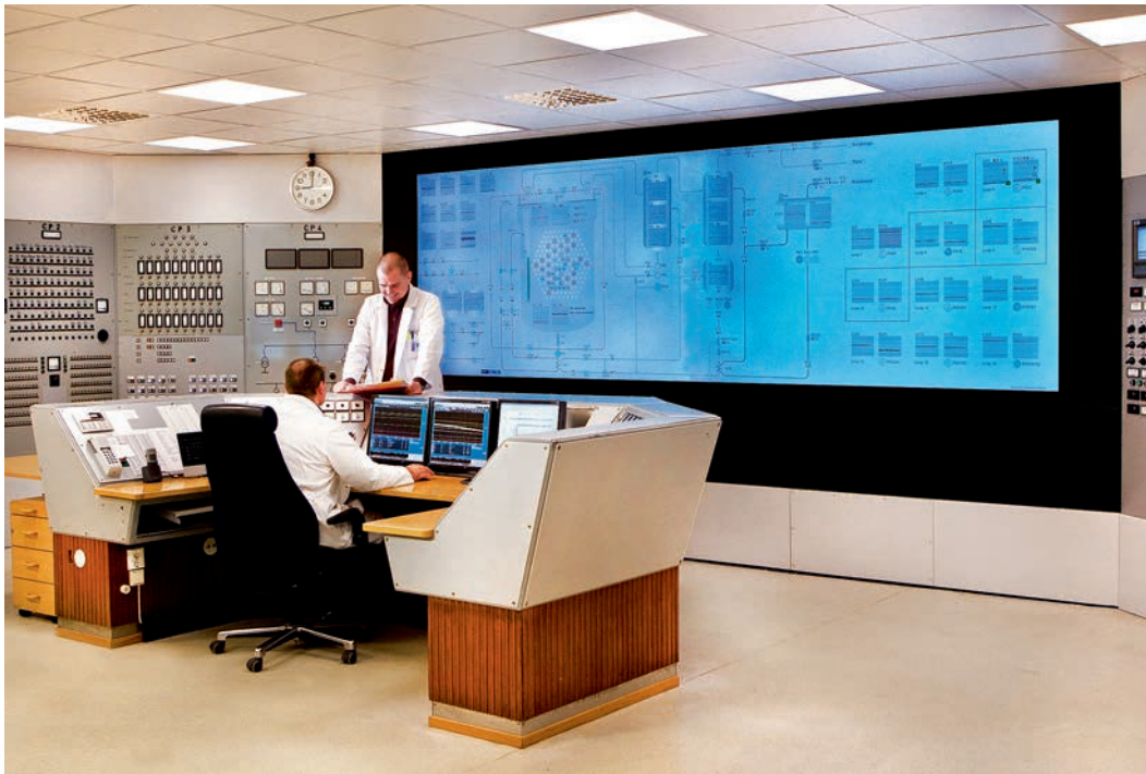
Abbildung 1: Der neue Kontrollraum des Halden-Reaktors. Dieser wurde 2012 modernisiert, wozu der Bereich Mensch- Technik-Organisation des HRP wesentliche Beiträge leistete. Quelle: HRP
