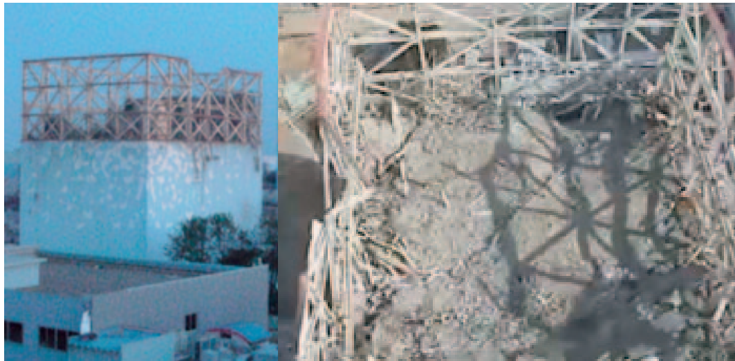
Figure 9 Et figure 10: Vues de la tranche 1 après l'explosion hydrogène (source: TEPCO).
