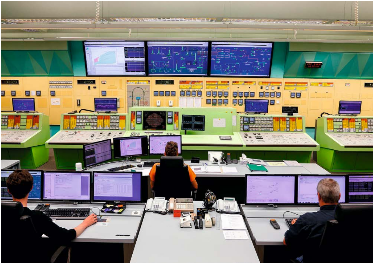
Kommandoraum des Kernkraftwerks Leibstadt. Bild: Axpo
