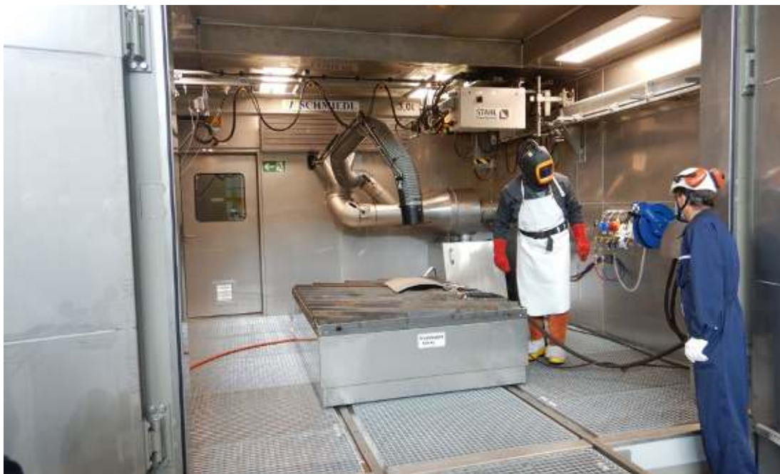
Bild 12: Während der Inbetriebsetzung des thermischen Zerlegecaissons wurden der Einschleusvorgang und die Zerlegung mit radiologisch unbelasteten Testteilen durchgeführt.
