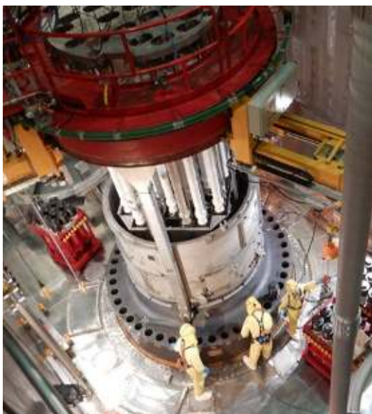
Bild 5: In der Reaktorgrube (Zone-IV) werden mit Schutzanzügen Arbeiten an den RDB-Deckel-Bolzen ausgeführt.
