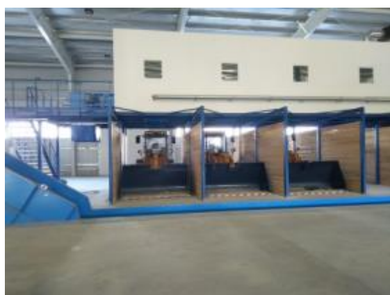
Stația de sortare – celule colectare fracții
