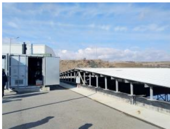
Stația de epurare levigată
