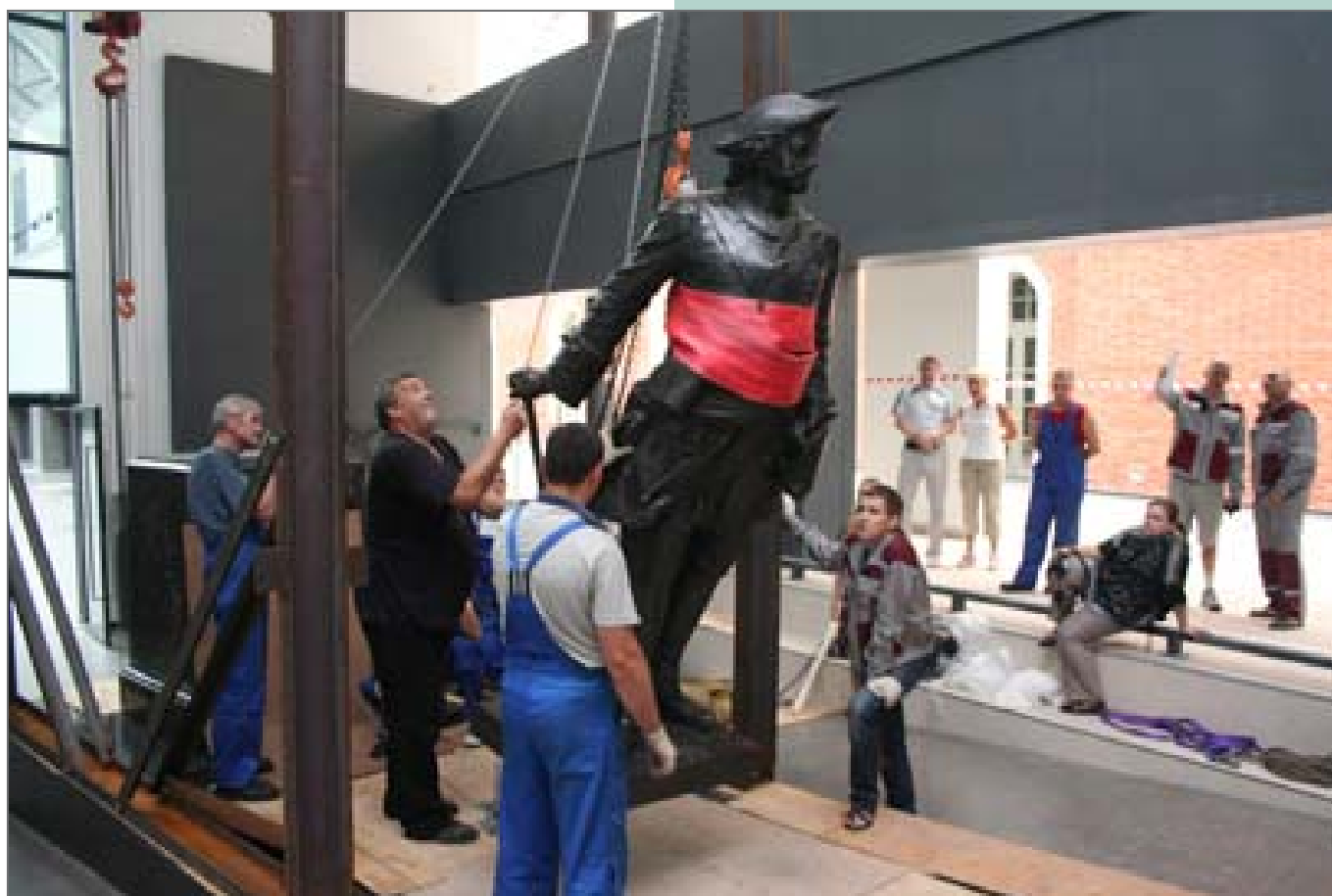
Установка скульптуры «Петр I» М. М. Антокольского в атриуме здания Крюковских Казарм
