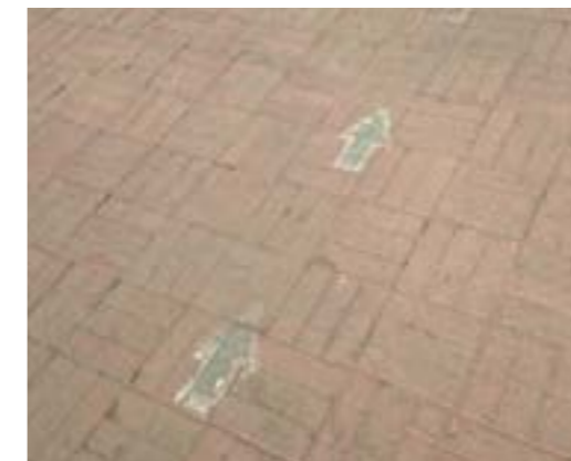
Рис. 129. На некачественном покрытии стрелки долго не держатся. Белая обводка добавила неряшливости.
