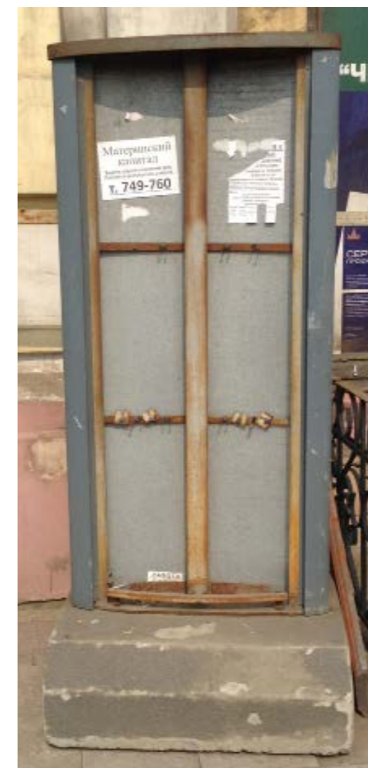
Рис. 148. Полностью разбитая стела «Зелёной линии».
