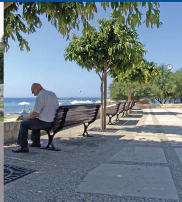
Επιδιόρθωση πεζοδρομίων, έργα προστασίας των πεζών, δάνοιξη λεκανών δένδρων και άλλα βελτιωτικά έργα στην παραλιακή λεωφόρο.
