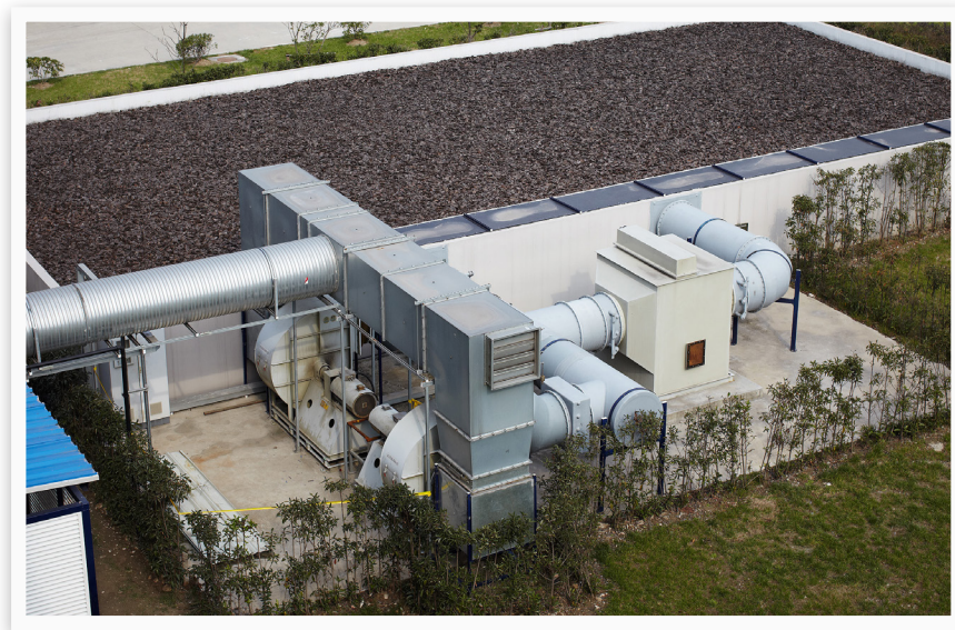
上海供應商工廠的屋頂上，裝設以樹皮製作的生物過濾器以過濾廢氣。這是工廠氣體排放管理系統的最後一個階段。
