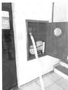
Foto 01 - Hidrante fundos - lado escadas
