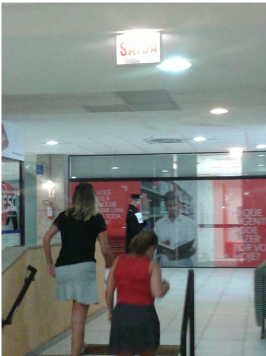
Placa luminosa de emergência indicadora de saída na Praça de Alimentação do CCEven
