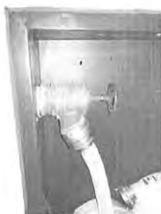
Foto 02 - Hidrante frente - lado agência bancária
