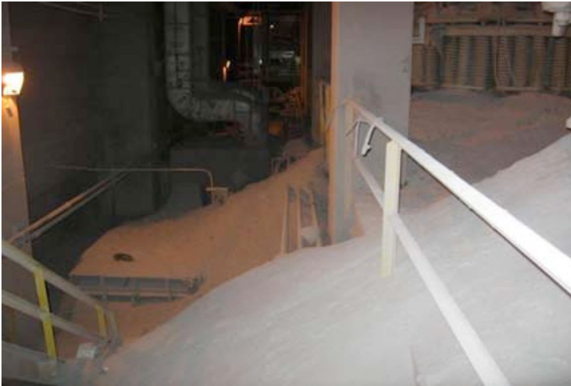
Foto No. 3: Condiciones de Trabajo: Acumulación de polvo sílice en la planta de concentración
