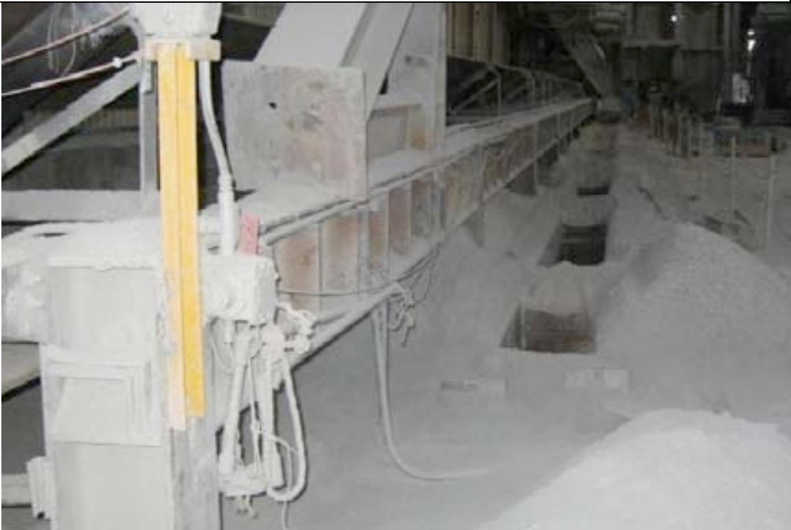
Foto No. 6: Acumulación de polvo y peligro de caerse en los huecos que no tienen barreras de protección
