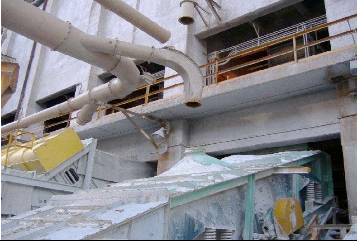
Foto No. 5: Sistema de colectores de polvo desconectado del sistema de ventilación local
