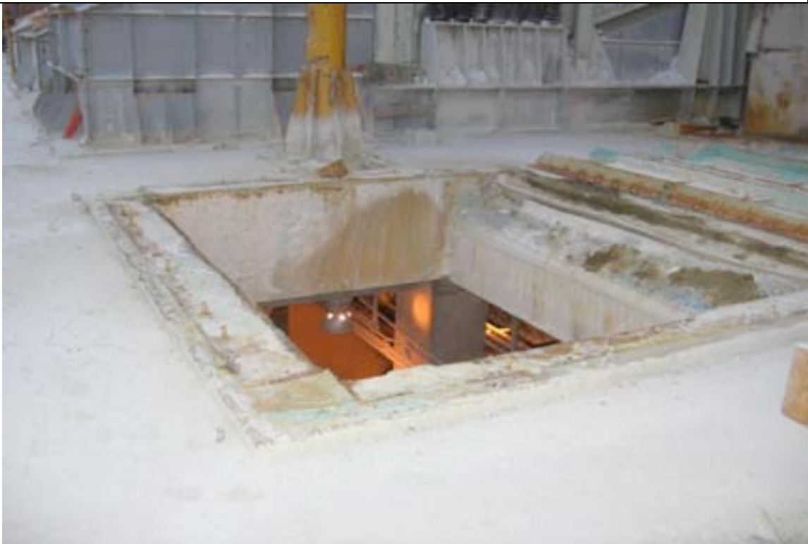
Foto No. 8: En el área de Concentrado existe peligro de caerse desde el hueco que no tiene barrera de protección
