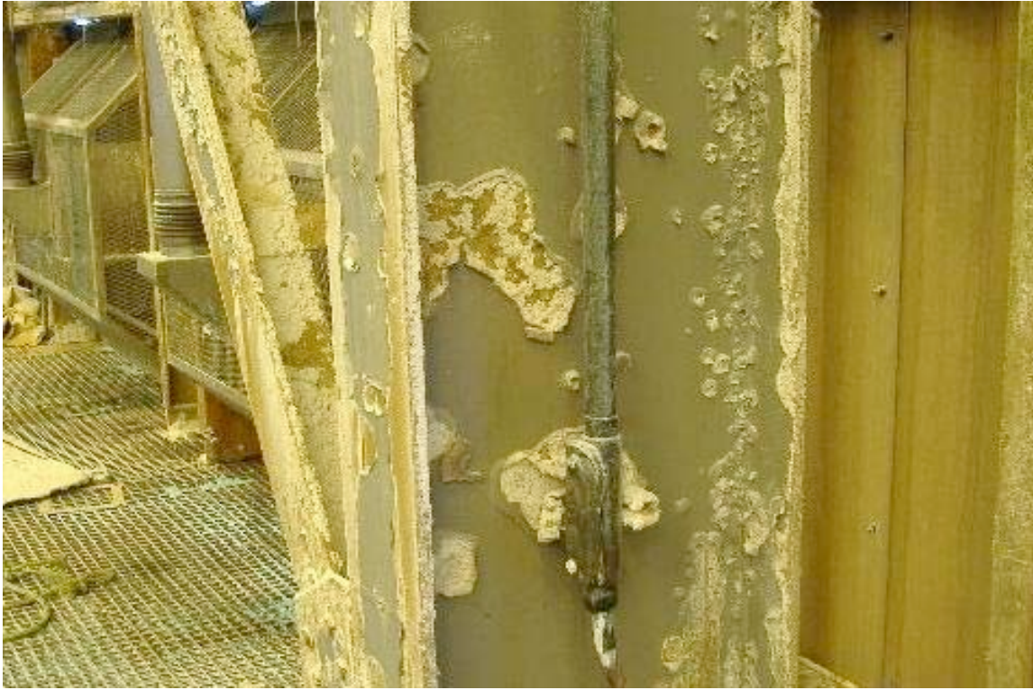
Foto No. 11: Peligro Químico: Metal corroído por la presencia de vapores ácidos en la planta ESDE
