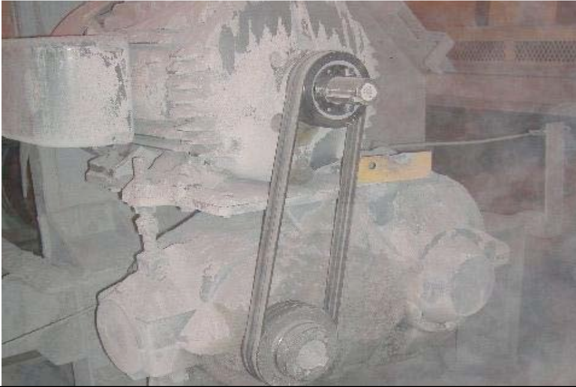
Foto No. 9: Peligro de la Maquinaria: Correa sin guardas en un motor de polea
