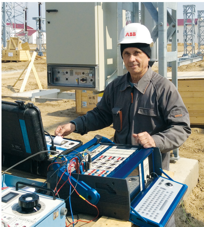
Виконання пусконаладжувальних робіт вимикачів LTB, 330 кВ, ПС 750 «Каховська», 2016р. на фото: Віктор Шершун, інженер АBB Україна
