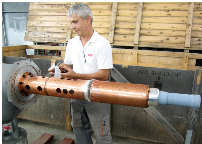
Виконання ремонтних робіт Т-модуля вимикача LTV 420, 2015р. на фото: Віктор Шершун, інженер АББ Україна
