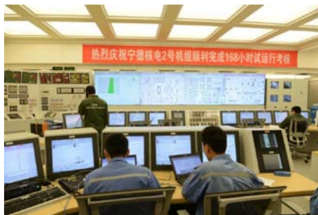
图 6 宁德核电厂 2 号机组具备商业运行条件
