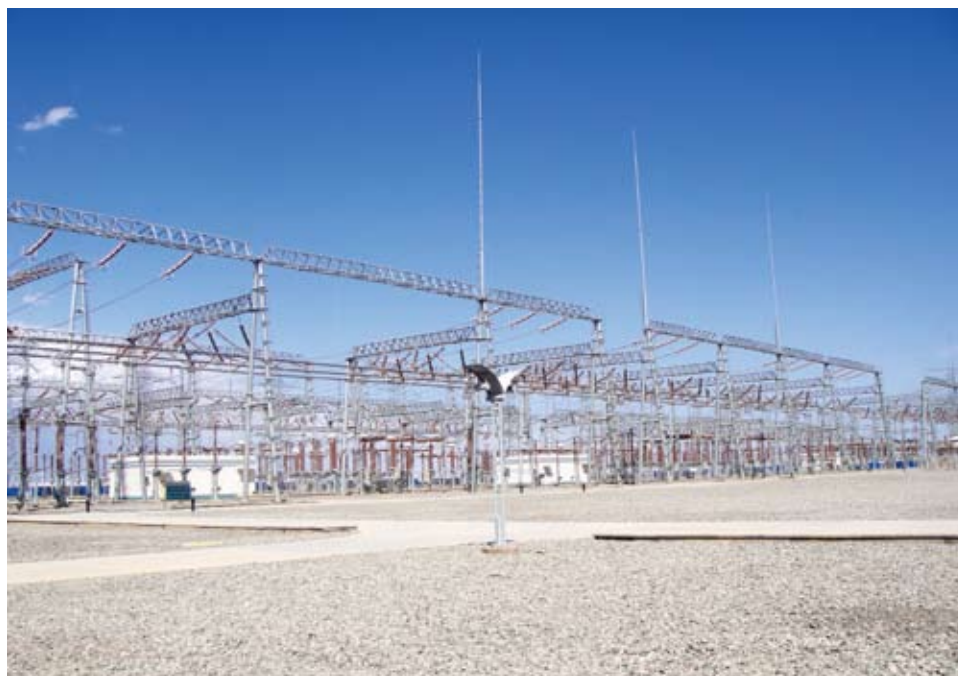
图 26 新疆与西北主网联网 750kV 第二通道输变电工程
