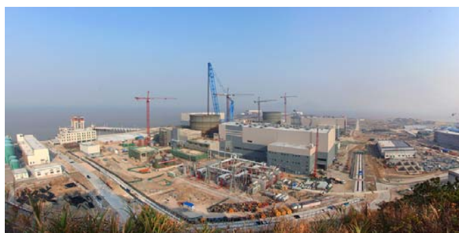
三门核电厂主厂址全景
