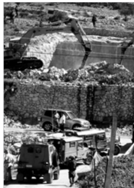
Izraelská armáda pomocí těžkých strojů, které dodávají firmy Hyundai, Volvo a Caterpillar, ničí zásobárnu vody v al Baqa 3. 9. 2009. V tomto případě se izraelské úřady ani nesnažily o zdání legality pomoci „demoličního výměru“.
