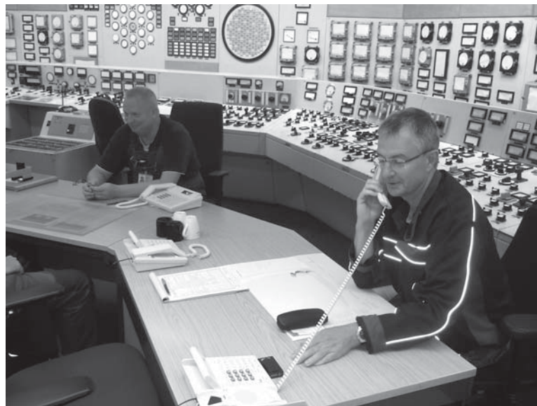
Hier in Rheinsberg in der Schaltzentrale wurde alles koordiniert
