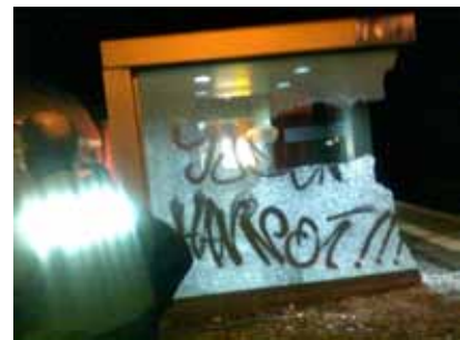
Zerstörtes Wartehaus am Bahnhof Weddel mit Farbschmierereien. (Foto: spiegel.de)
