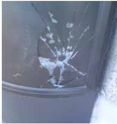
Zerstörte Frontglasscheibe am damaligen Gruppentreffpunkt der UB (Foto: privat)
